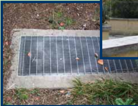
Sistema di aerazione
