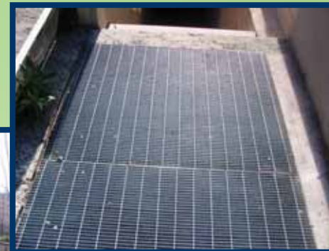
Sistema di aerazione
