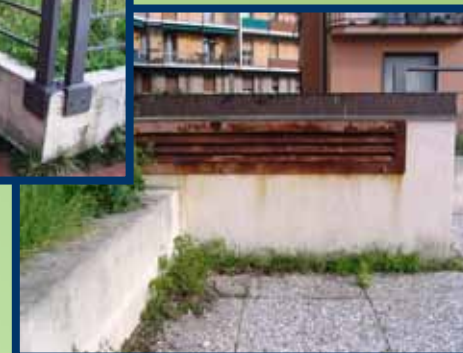
Sistema di aerazione
