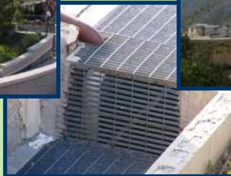
Sistema di aerazione
