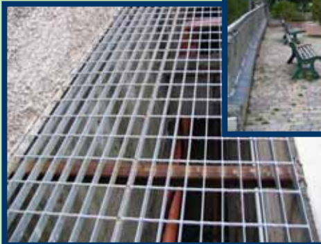
Sistema di aerazione
