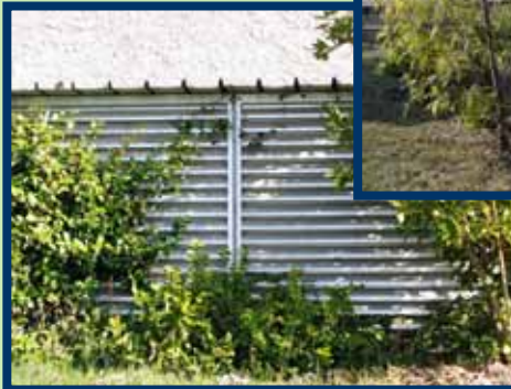
Sistema di aerazione
