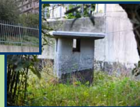
Sistema di aerazione
