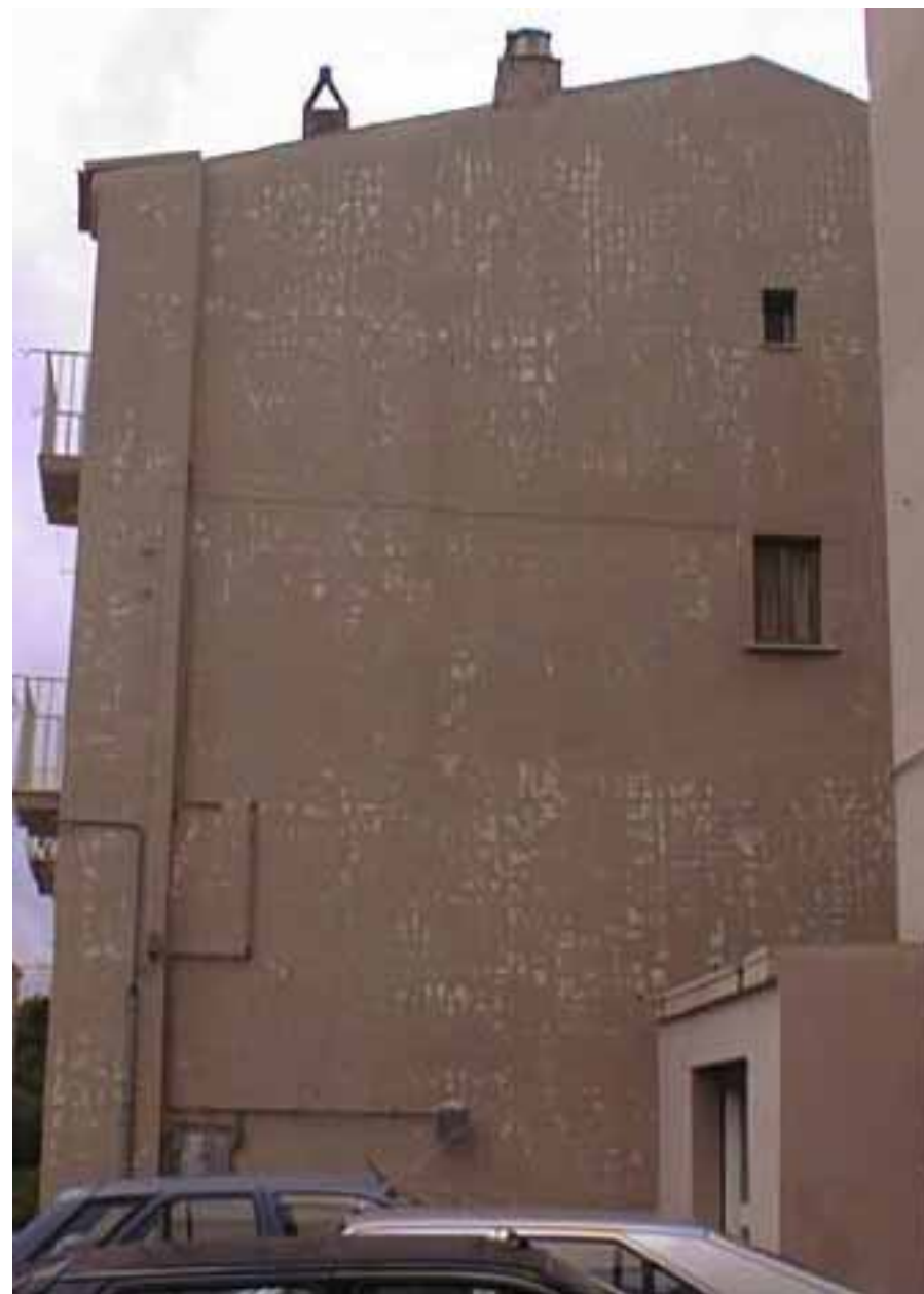
Fenomeni di degrado
