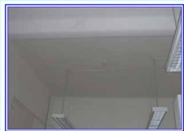
Figura 2, locale 11, soffitto verso la parete A, parte a sinistra
